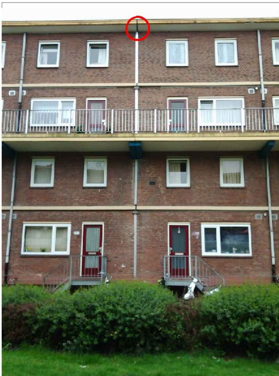
Foto 1: Voorbeeld van spleet in gevel/dakrand
