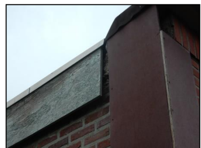
Figuur 8. Detailfoto transformatorhuisje.
