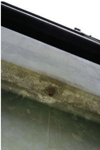
Figuur 12: Onderzijde boutverbinding
