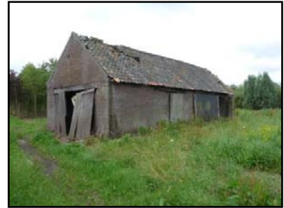
Figuur 11. Vervallen schuur op onderzoekslocatie.
