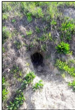
Figuur 4. Pijp das in talud N295, in het oostelijke gedeelte van de planlocatie.
