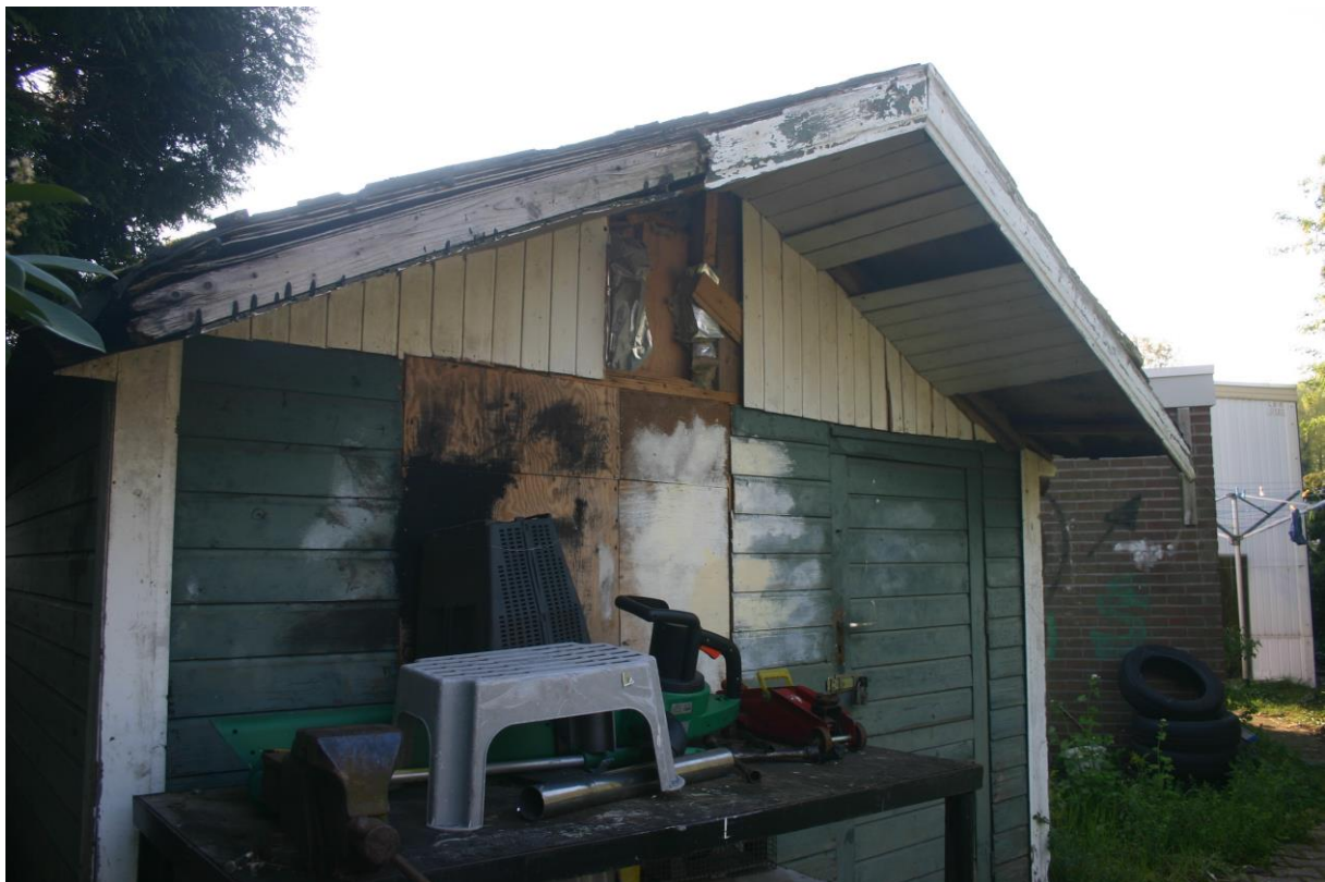
Figuur 7. Sommige bijgebouwen hebben gaten en kieren die groot genoeg zijn om vleermuisverblijven te bevatten.
