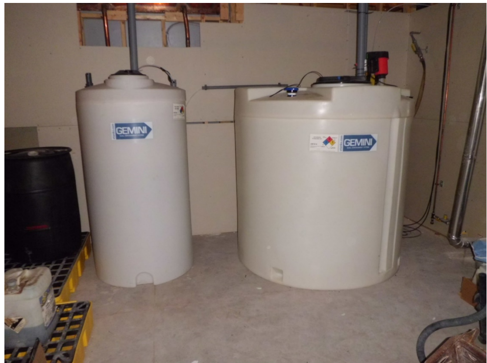
Figuur 12 Zuur ( H_2SO_4 ) en Alkali of Loog (KOH) tanks.
