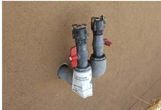
Figuur 13 Vulpunten voor KOH en H 2 SO 4 oplossingen aan de buitenkant van het gebouw.
