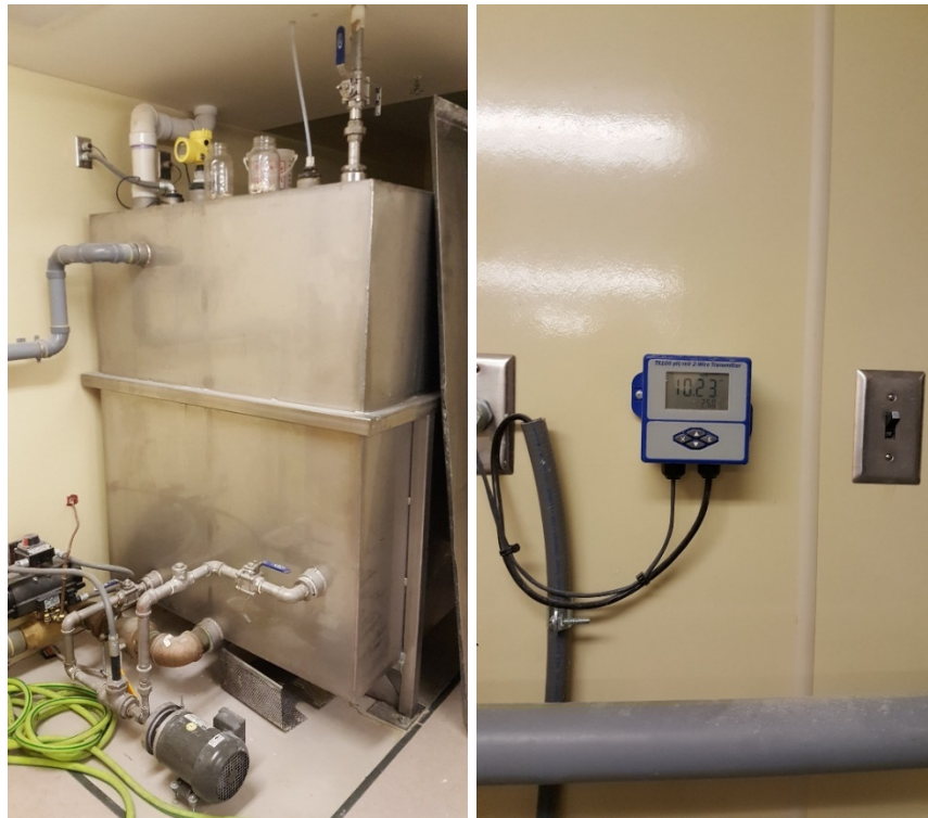
Figuur 9 Effluent tank (links) en pH meter die pH in de effluent tank reguleert (rechts)
