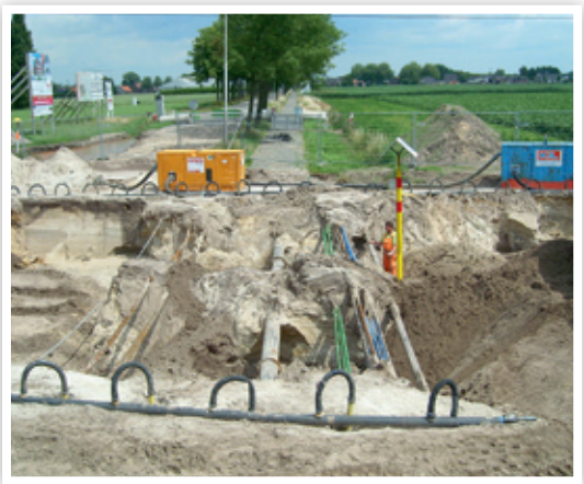
Kabels en leidingen
