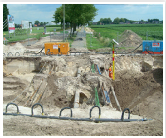
Kabels en leidingen
