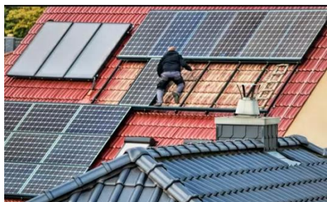
Figuur 22: Zonneboiler en zonnepanelen
