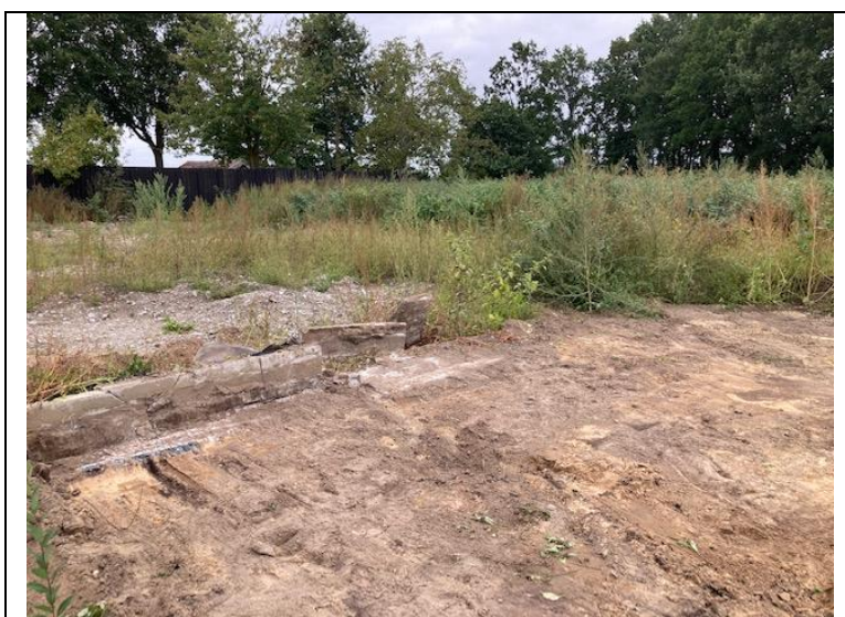
Foto 2: betonband aanwezig ter plaats van de westelijke oprit en de (voormalige) stal
