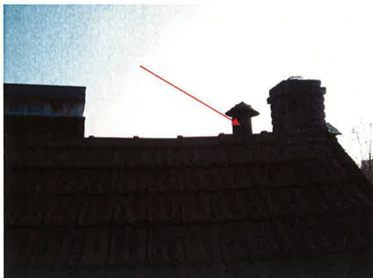
Foto 7: asbesthoudende pijp op het dak van Laurentiusstraat 88.
