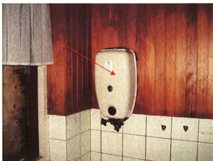
Foto 9: asbestverdachte geiser in de keuken van Steegstraat 28.
