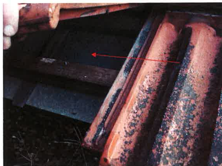
Foto 6: asbesthoudend dakbeschot op het dak van Steegstraat 30.
