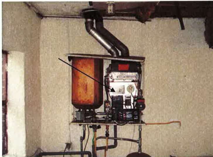
Foto 11: asbestvrije CV-ketel in de berging van Steegstraat 30.
