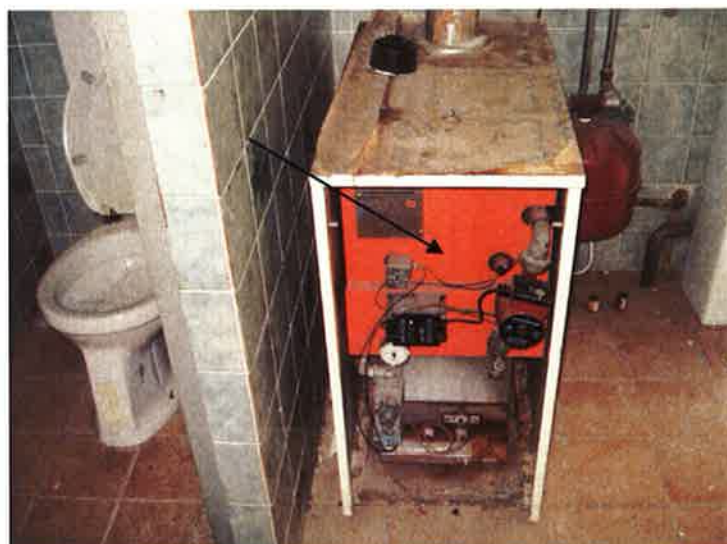
Foto 12: asbestvrije CV-ketel in de berging van Laurentiusstraat 88.
