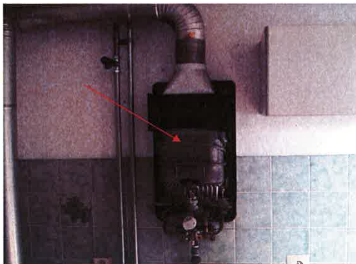
Foto 13: asbesthoudende geiser in de berging van Laurentiusstraat 88.
