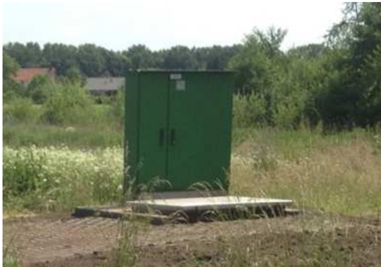
Schakelkast gemaal, bij pompput
