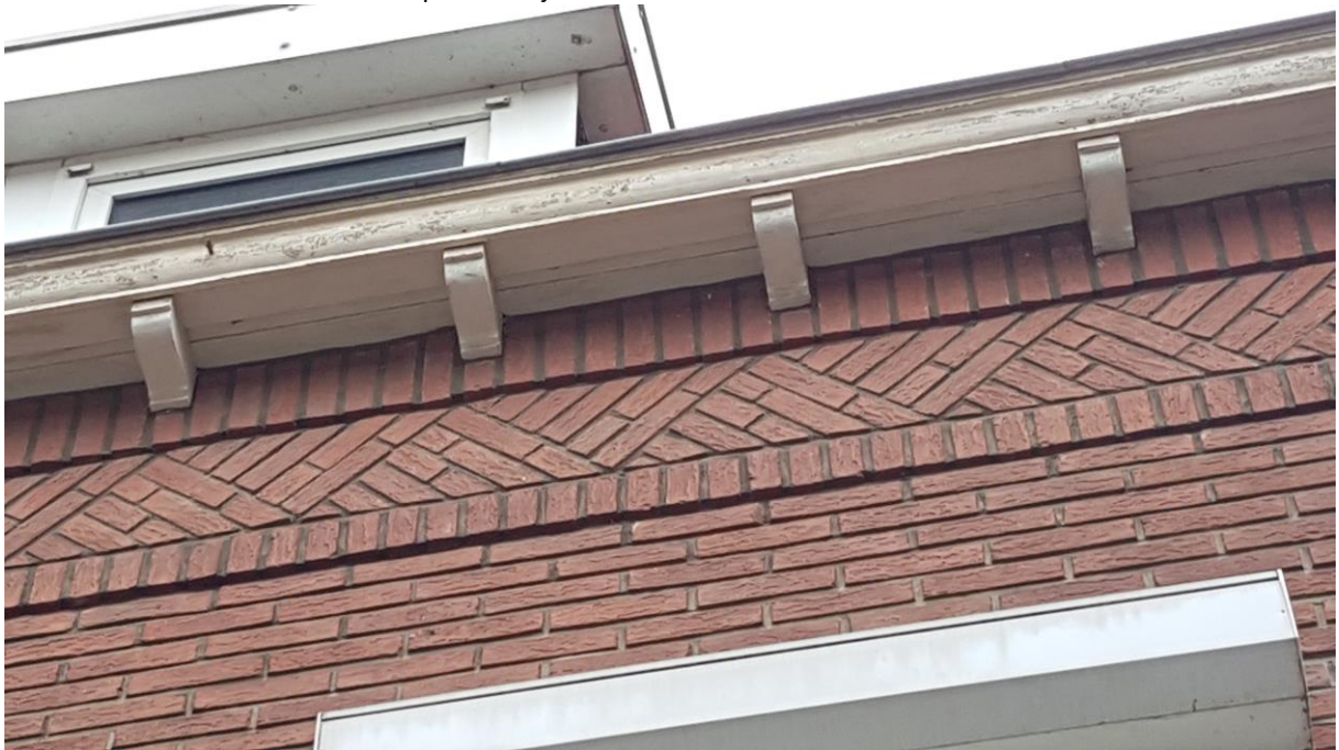
Foto 8: het houtwerk sluit aan tegen de bakstenen waardoor hier geen openingen zijn.
