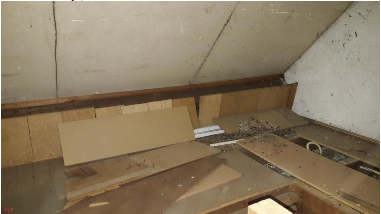
Foto 12: oud nest aangetroffen op de zolder vermoedelijk van een duif.
