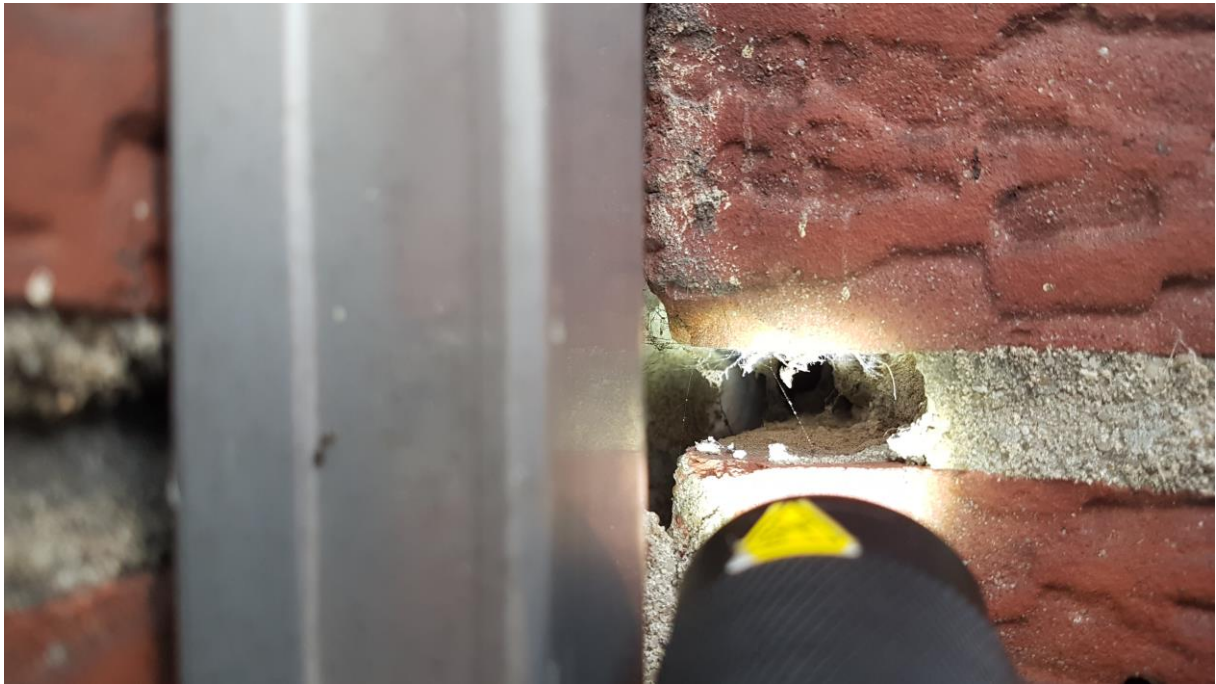
Foto 9: gat in de hoek van de gevels wat naar de spouw leidt.
