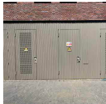
Traforuimte ingepast in de gevel
