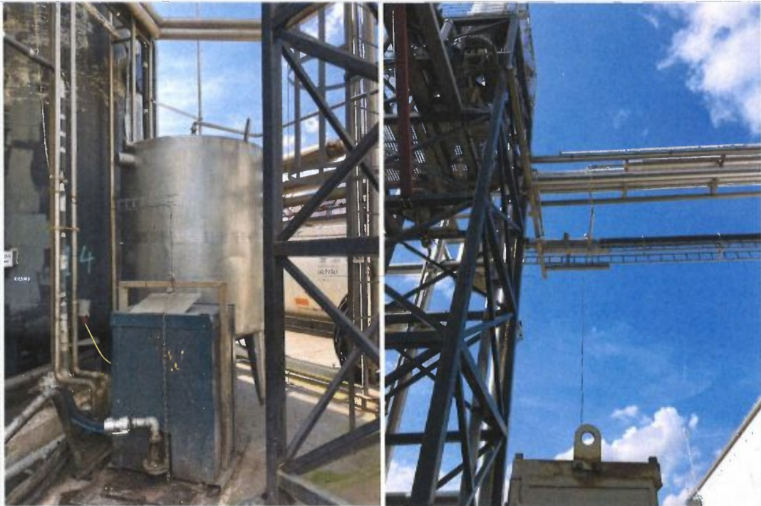
Buffertank en onderaanzicht warmte wisselaar
