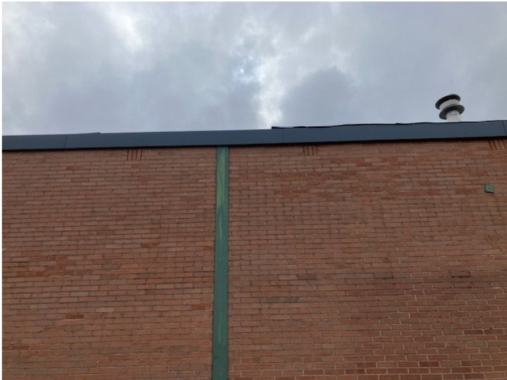
• Afbeelding 17: Linker zijgevel hal, onder de dakrand diverse open stootvoegen
