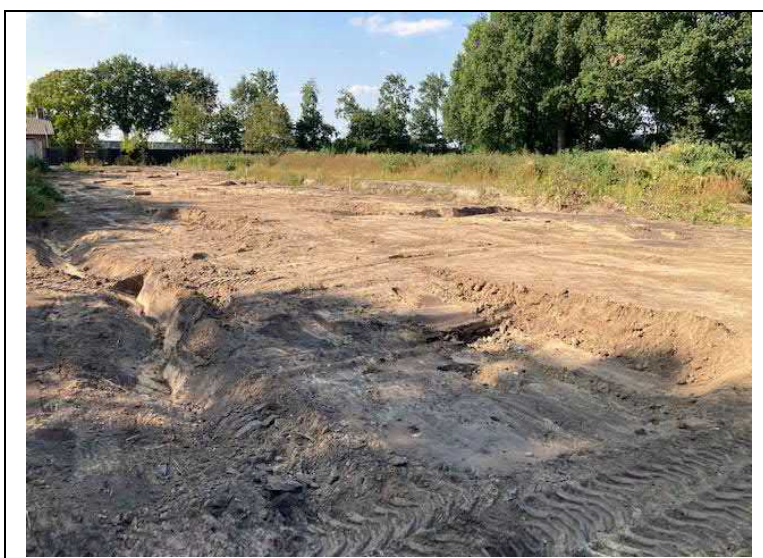
Foto 5: ontgraven van de bodem B3, B4 en B5 gezien vanuit het oosten
