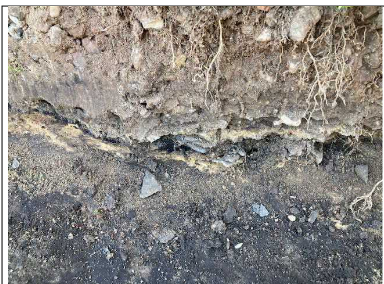
Foto 9: duidelijke restverontreiniging met asbestmaterialen bij de perceelsgrens
