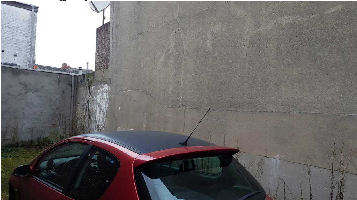
Foto 6: het braakliggende gedeelte wordt gebruikt als parkeerplaats en is verhard met stoeptegel.
