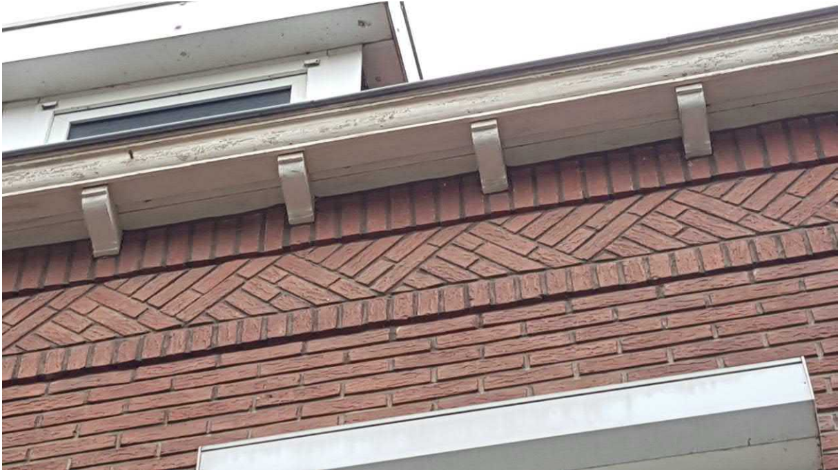
Foto 8: het houtwerk sluit aan tegen de bakstenen waardoor hier geen openingen zijn.
