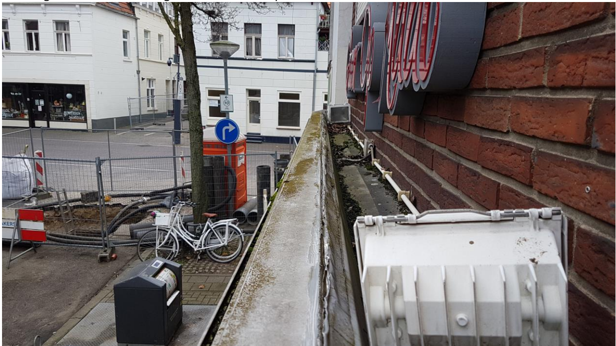
Foto 10: twee gevel lampen die net iets lager staan dan het gat in de hoek (foto rechts).
