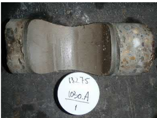
Foto 11: Bij het inkaderen van de verontreiniging in boring 1030 wordt een asbestleiding in de 28 cm dikke betonnen vloer aangetroffen.
