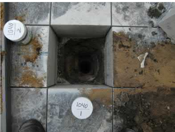
Foto 5: Onder 24 cm beton heeft de bovengrond een zwakke bijmenging met beton, baksteen en metaalslakken. Daaronder een boring tot 2 m-mv.
