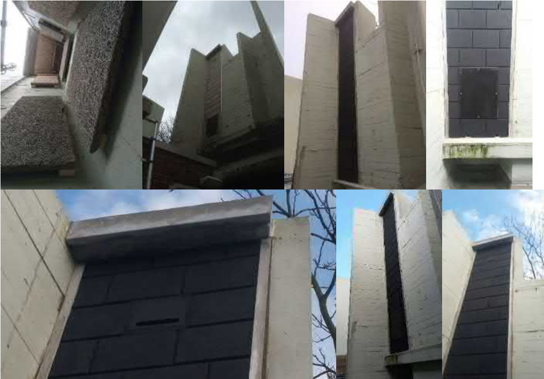
Impressie vleermuisverblijf in oude schoorstenen (3x gebouwd)
