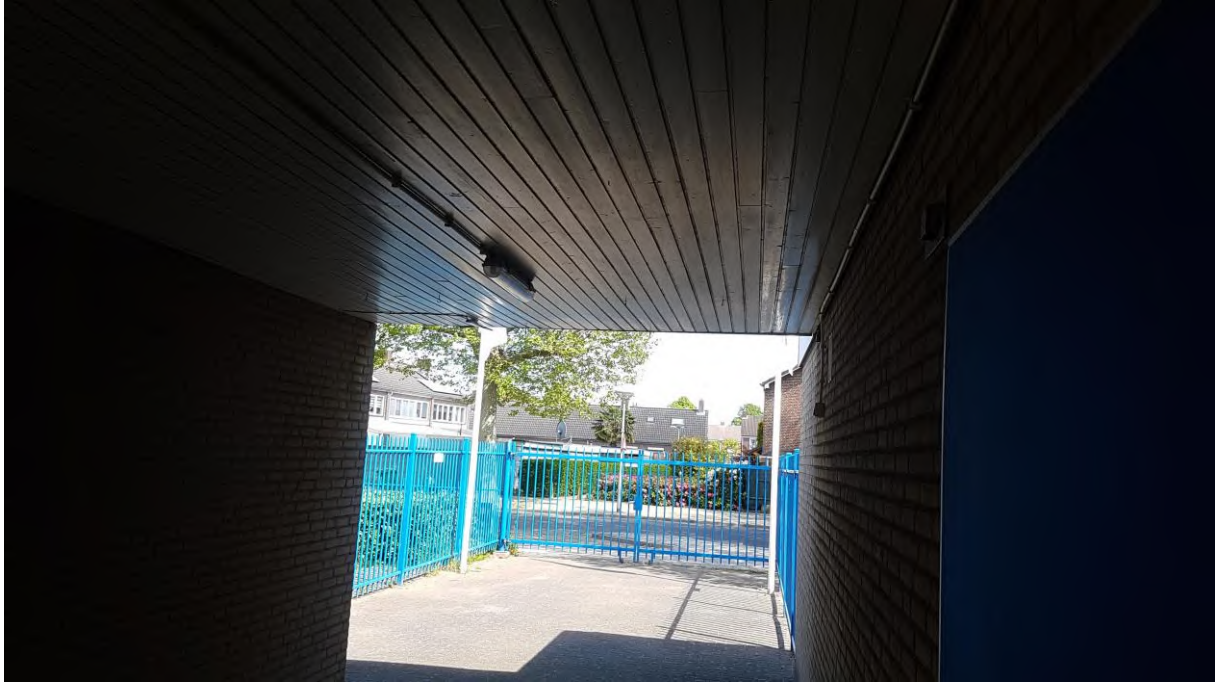
Foto 3: de overdekte gang tussen het binnen bad en de clublokalen heeft een houtenplafond met enkele spleten.
