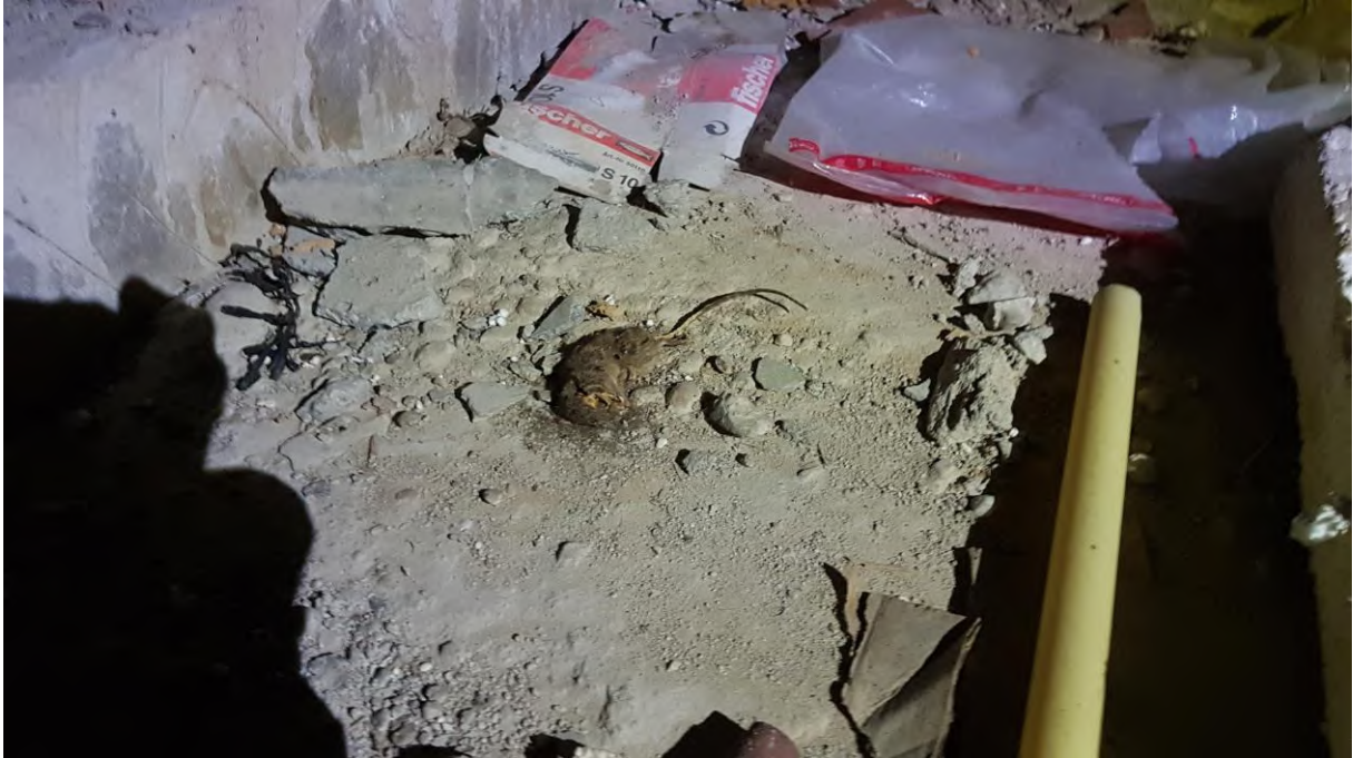
Foto 15: een dode muis aangetroffen in de kruipruimte onder het zwembad. Het enige dierspoor aangetroffen in de kruipruimte.
