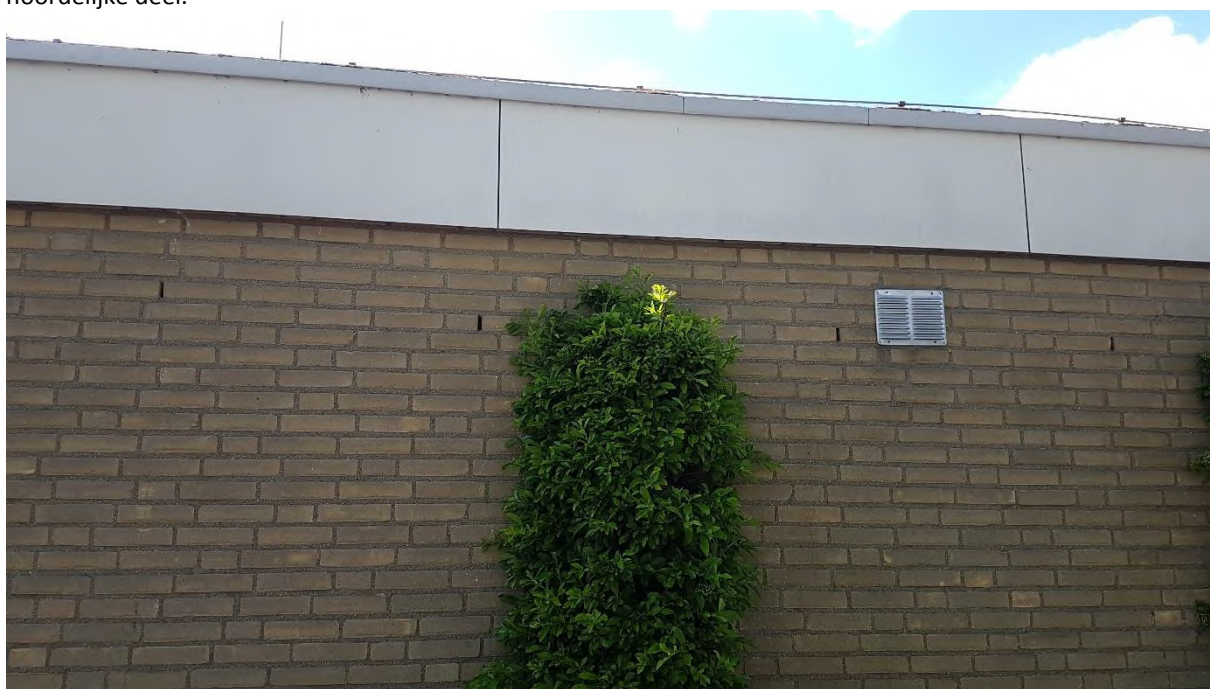
Foto 24: openstootvoegen op het noordelijke deel van de westelijke gevel van de clublokalen.
