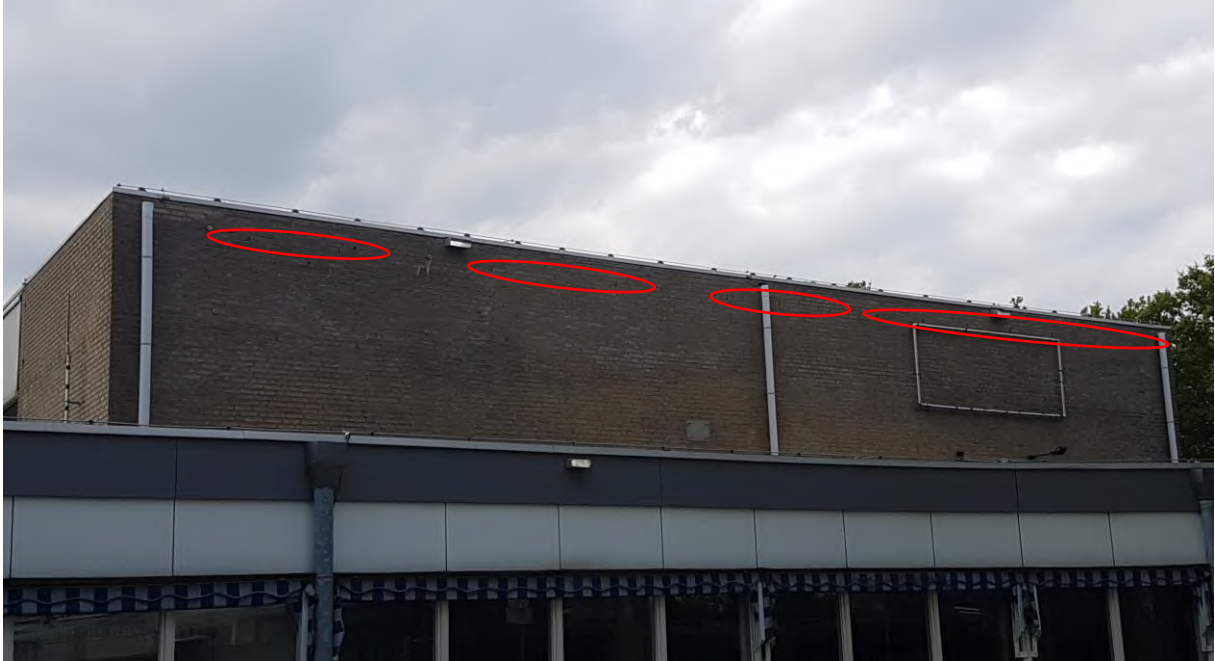
Foto 7: openstootvoegen op de oostelijke gevel van de 1 ste verdieping.
