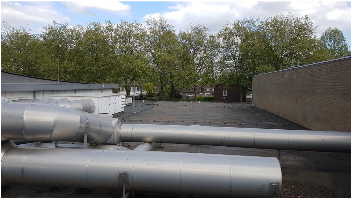
Foto 10: het dak tussen de twee binnenbaden van het te slopen pand. Er zijn geen sporen van (oude) nesten.
