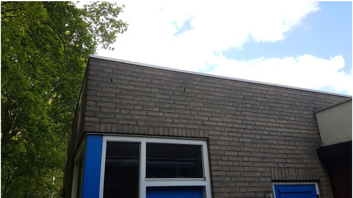
Foto 26: openstootvoegen op de westelijke zijde van het etablissement.
