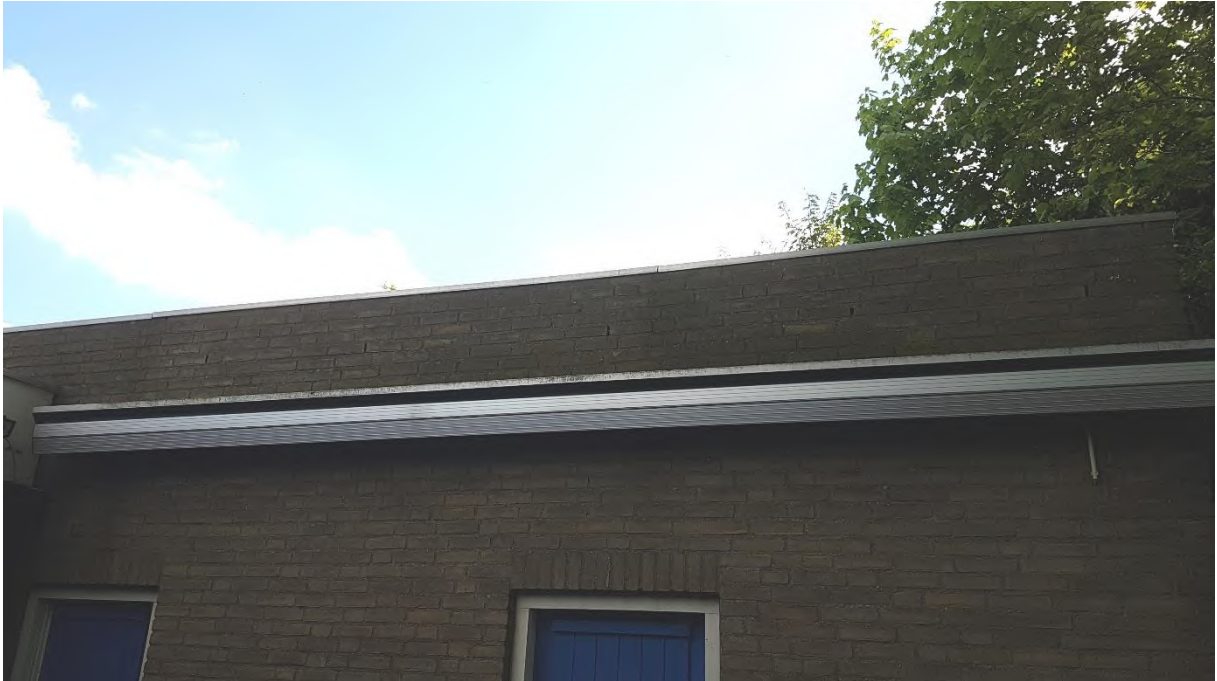
Foto 27: openstootvoegen op de westelijke zijde van het etablissement.
