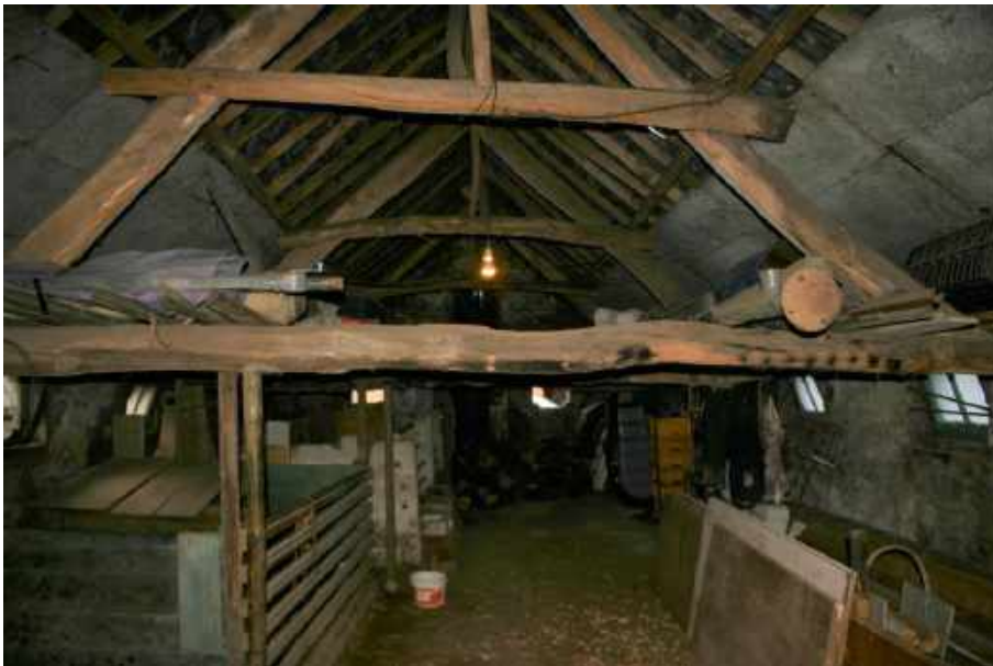
Figuur 4.4.5. De voormalige stal met dakbeschot aan het onderste deel van het dak.
