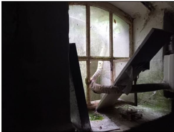
Foto 13: open raam biedt toegang tot kelder
