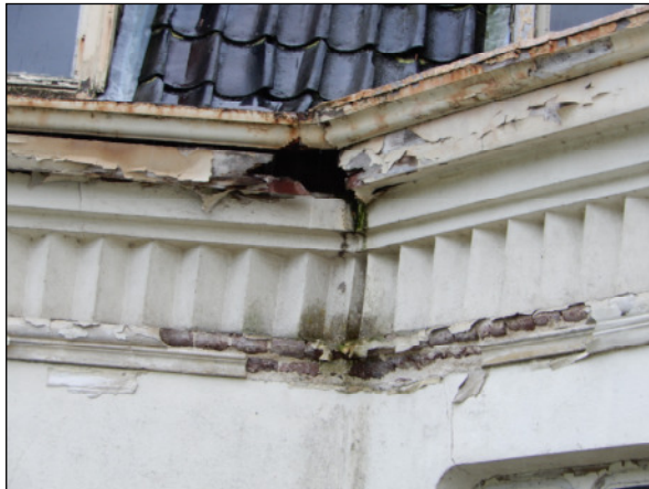
Foto 4: openingen in daklijst
