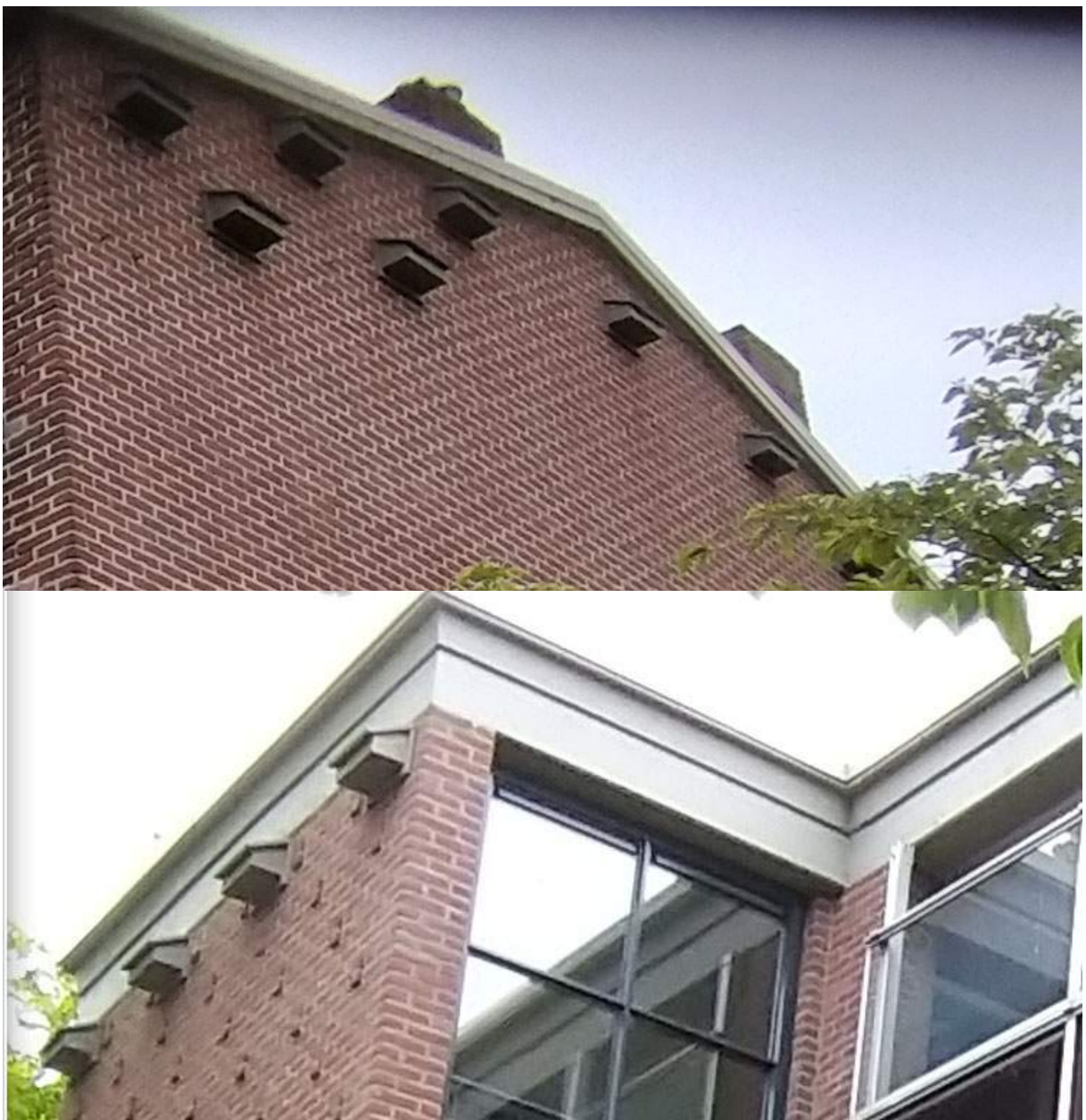
Foto's 3bis en 4bis: Gierzwaluwkasten aan de gevels
